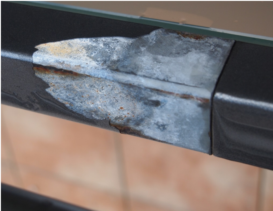
Weißrost an verzinkten Bauteil wurde nicht entfernt
